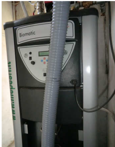
La BIOMATIC 30 nella piccola Centrale termica
