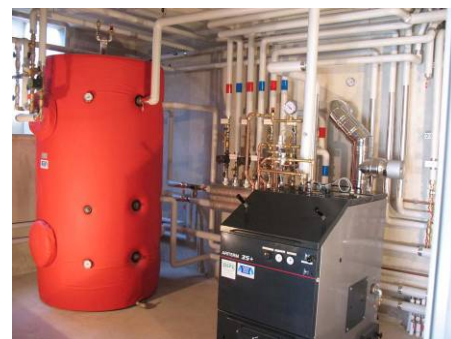
Un impianto ben progettato dello Studio ESSEPI e realizzato con cura e precisione
